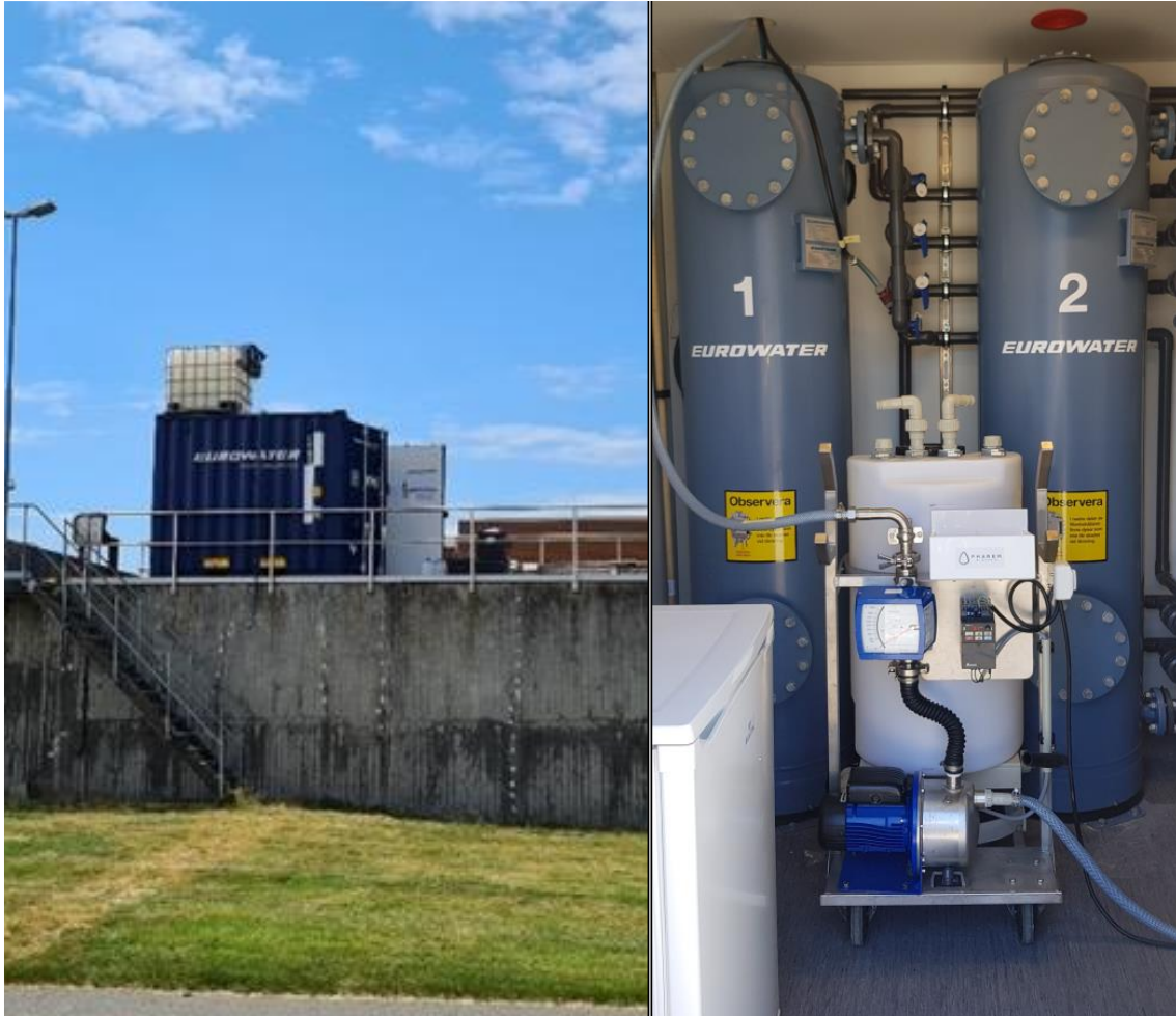
FIGUUR 10 FOTO'S VAN DE PILOT OP RWZI KRISTIANSTAD EN DE TWEE FILTERKOLONNEN IN DE PILOT CONTAINER
