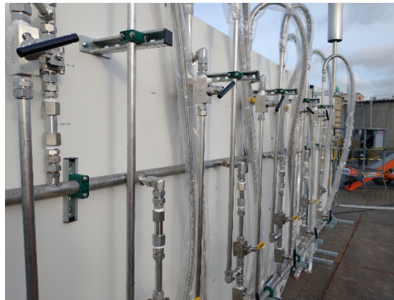
Leidingwerk aan de PO buffer met reduceerventielen en veiligheidskleppen
